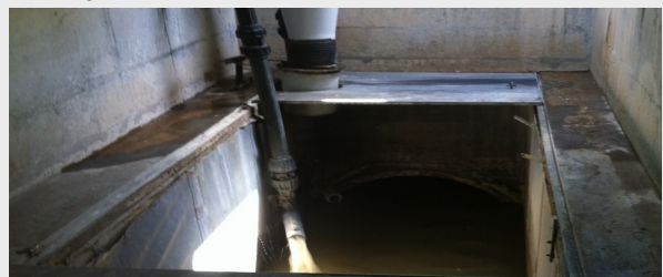
Entrada de la principal estación de bombeo del sistema de saneamiento de la Ciudad de Salalah (Sultanía de Omán). © DHI
